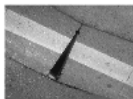
モルタル脱落（危険）
